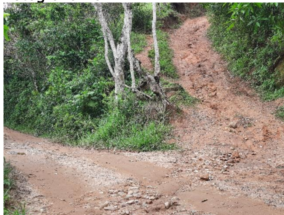
Fotografía 10. Vía sin lastrar
